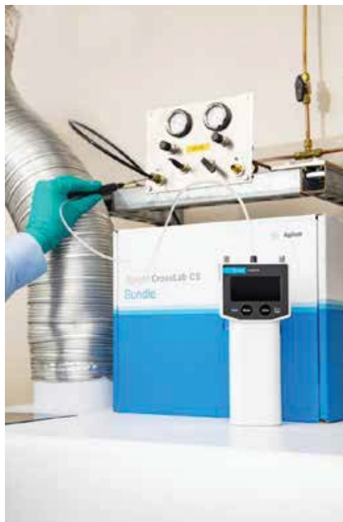
Figure 10. Exemple d'utilisation d'un détecteur de fuite électronique Agilent CrossLab CS pour vérifier les raccords avec de l'argon.
